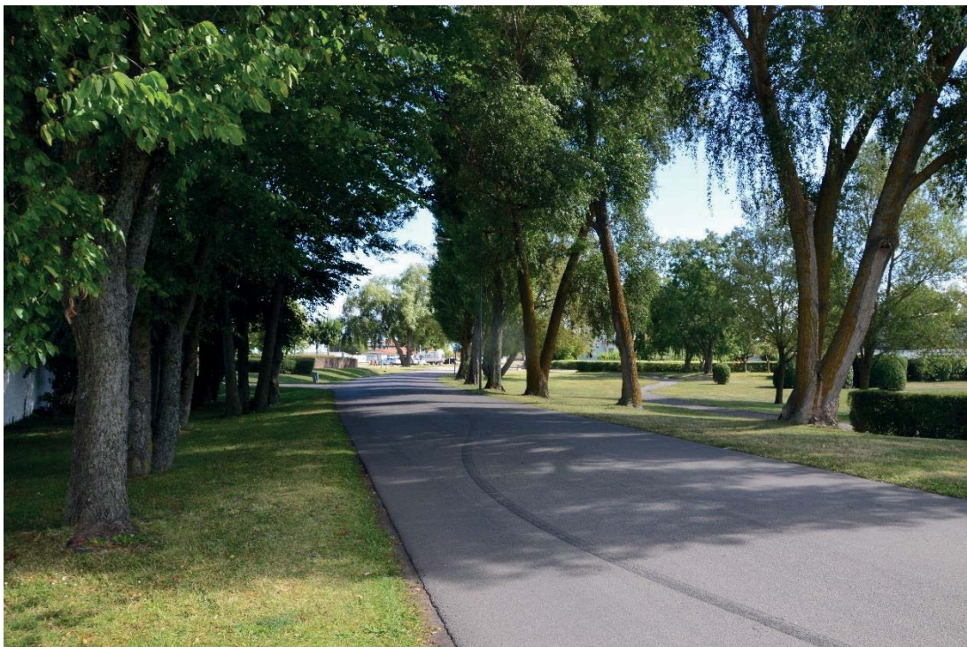
Allé 7 längs med Sandgatan utgörs av en oregelbunden allé som tydliggör gränsen mellan staden och kyrkogården. Häckpopplar i allén riskerar stambrott och åtgärder bör sättas in snarast.
