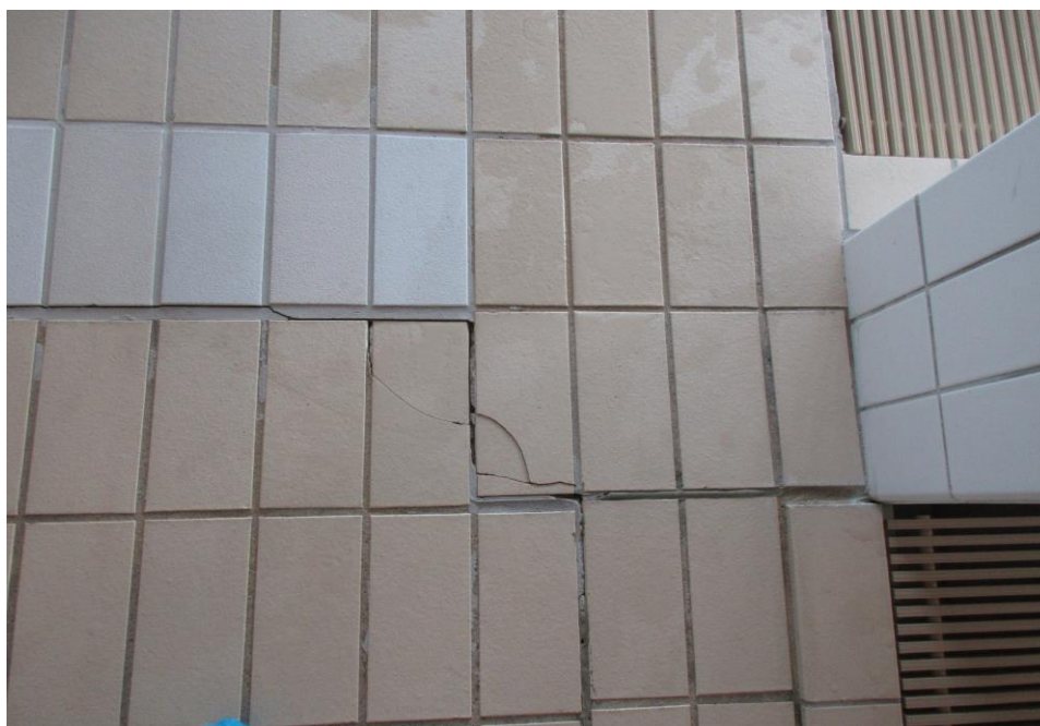
Spricka i fog och sprickor/skada i golv mot bubbelpoolen.
