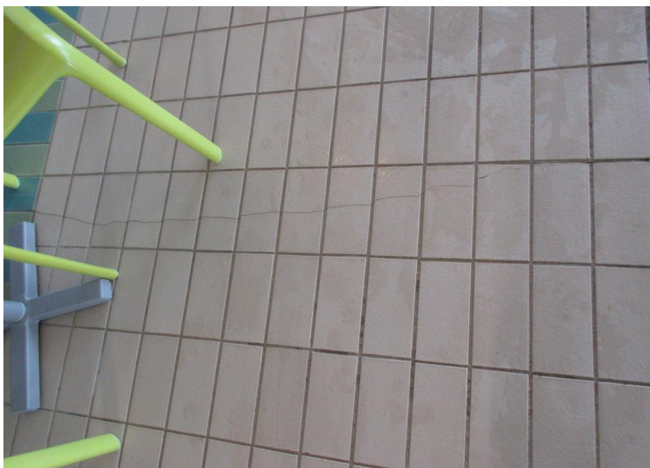
Spricka i golvet med släpp i fogen.
