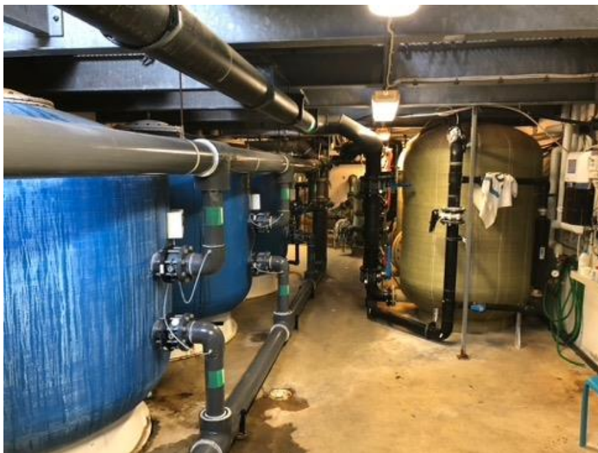
Filter 3-1 till vänster. Till höger filter till bubbelpool och barnbassäng.
