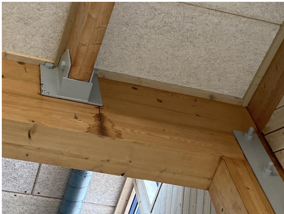
Bilden visar rinningar på limträbalken vid infästning i hörnet mot syd-öst i badhallen.
