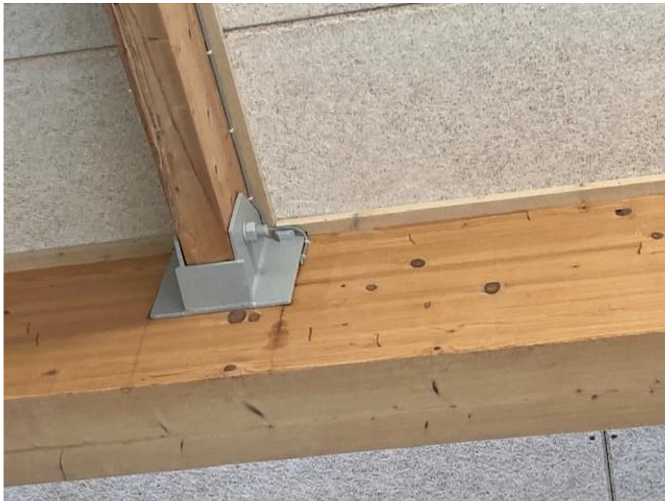
Bilden visar rinningar på limträbalken vid infästningsbeslaget, läget på detta är i södra delen på badhallen.
